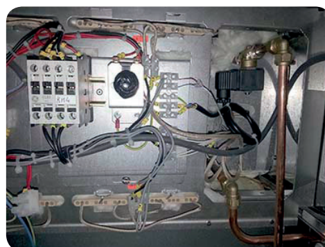
Электрическая установка для производства пара
